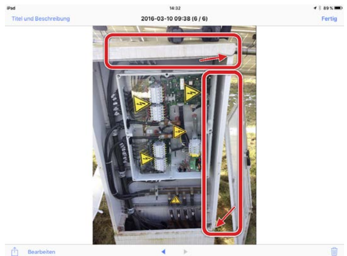
Ein Mangel wurde mit Markierungen versehen.
